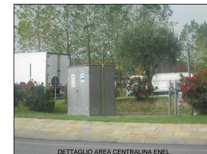
DETTAGLIO AREA CENTRALINA ENEL
